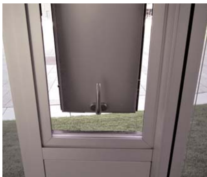
Die Fenster der Bürohäuser lassen sich zumindest kippen. Auch wenn dadurch die Klimaanlage oft umsonst kühlt
